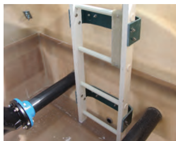
Echelle avec crosse rétractable dans la chambre à vannes
