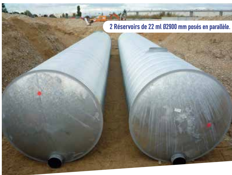
Réservoir de 22 ml Ø2900 mm soit 150 m 3 (5,8T) posé à la grue.
